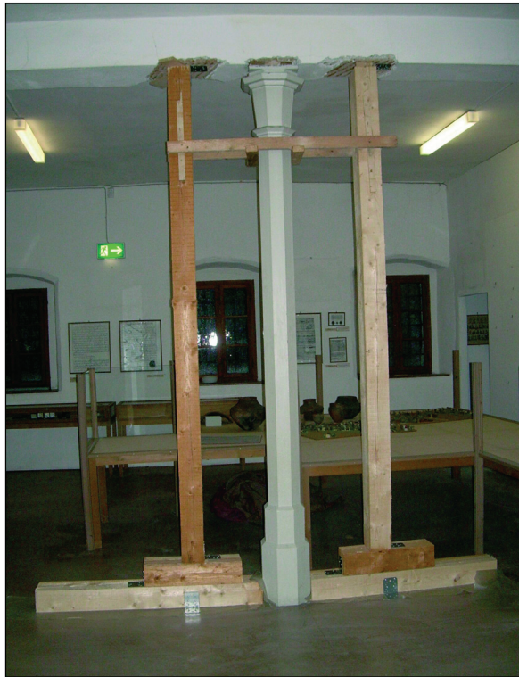
Die Eisensäule wird mittlerweile durch Holzsteher stabilisiert
